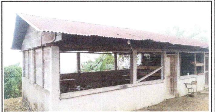
Foto 4: Módulo 4 - se necesita cambiar las láminas del techo en total deterioro, cambiar las tablas por block, cambio de puertas de madera a metal y ventanas.
