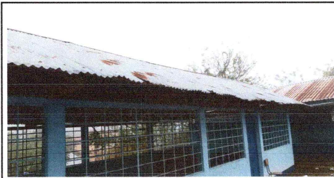
Foto 1: Módulo 1- se necesita cambiar las laminas del techo y remozar pintura interior y exterior, anticorrosivo de puertas y balcones.
